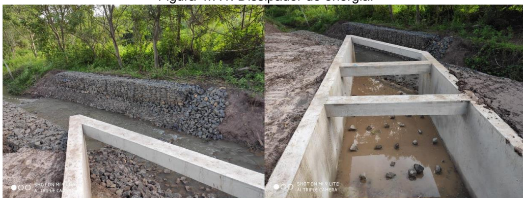
Figura 4.7.1: Dissipador de energia.
