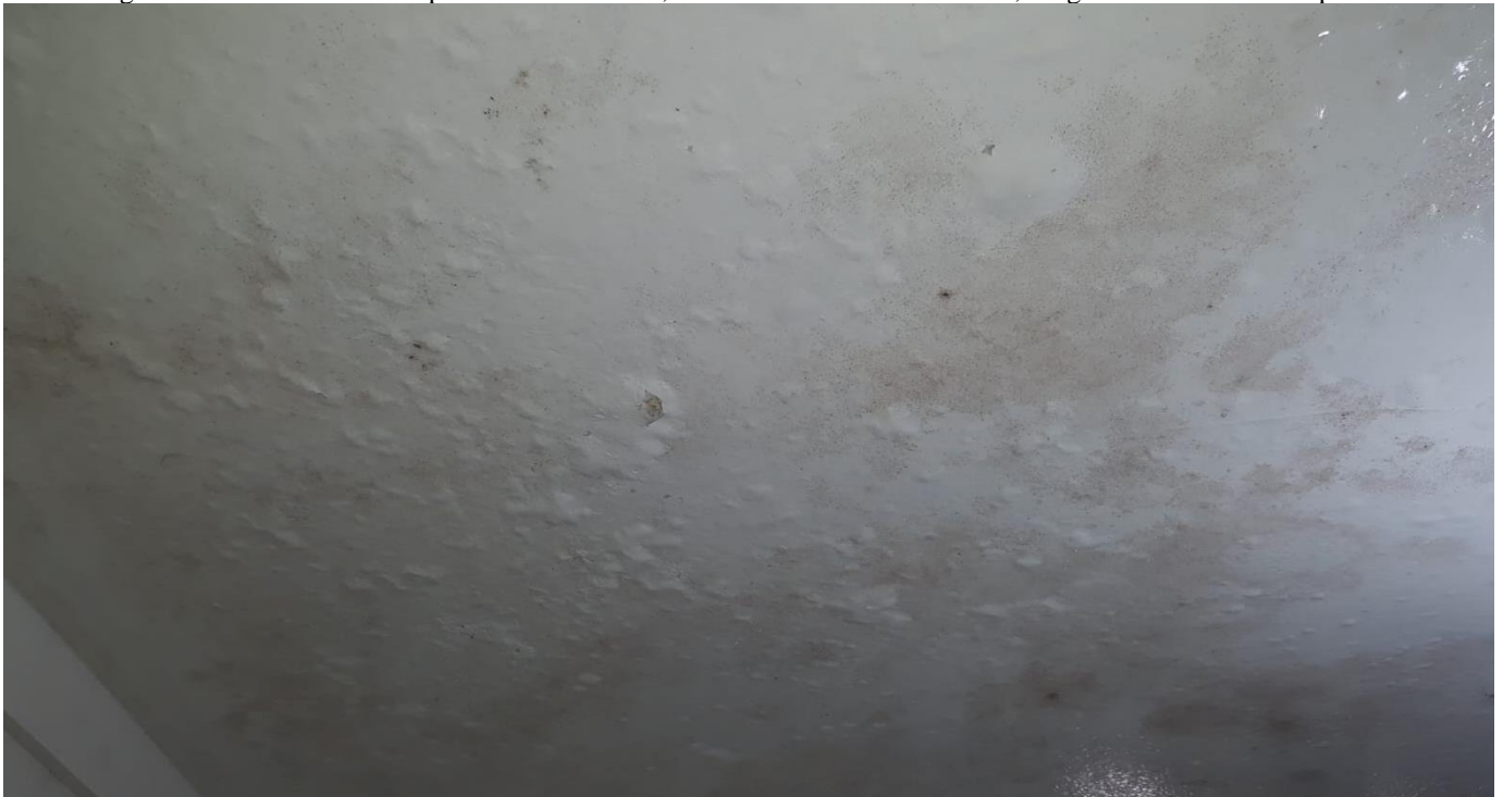
Figura 23: Vista interna do apartamento 3º andar, teto do banheiro com bolores, fungos e estufamento da pintura
