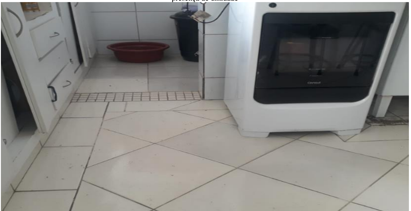
Figura 5: Vista interna do apartamento 1º andar, diferença de tonalidade entre os pisos onde a região mais escura indica presença de umidade
