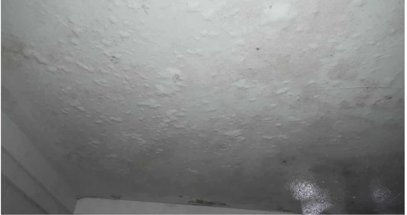
Figura 22: Vista interna do apartamento 3º andar, teto do banheiro com bolores, fungos e estufamento da pintura
