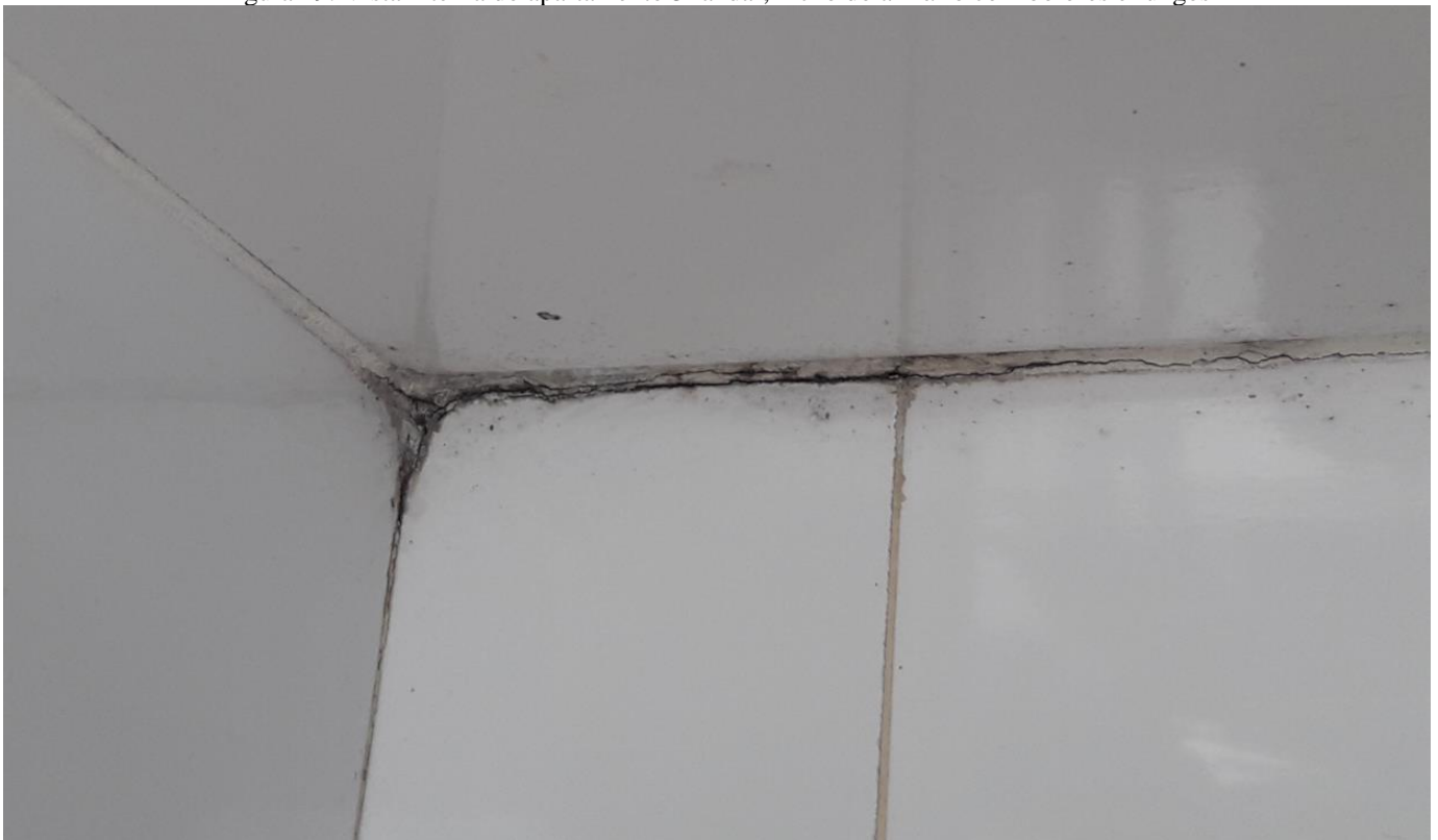
Figura 19: Vista interna do apartamento 3º andar, nicho do armário com bolores e fungos
