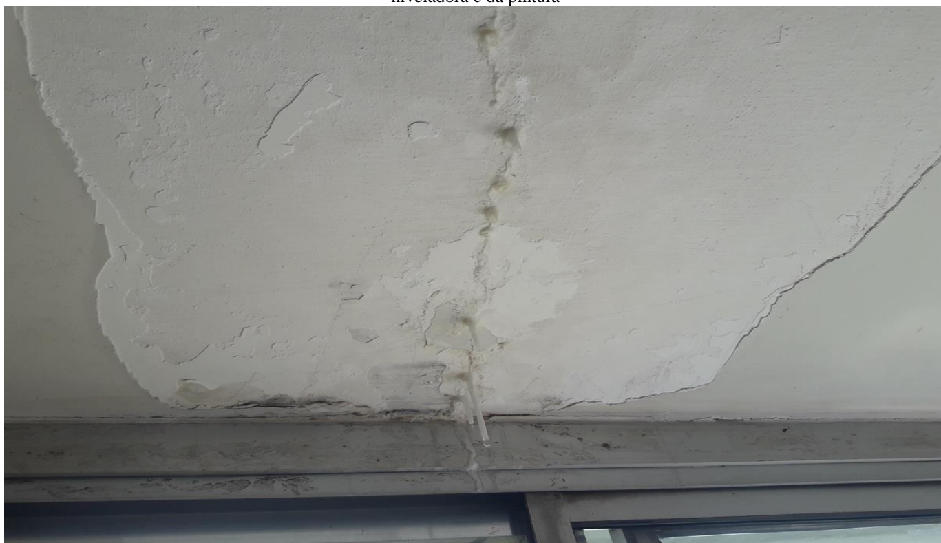
Figura 11: Vista interna do apartamento 3º andar. Infiltração na laje da sala e formação de estalactites, deslocamento da massa niveladora e da pintura
