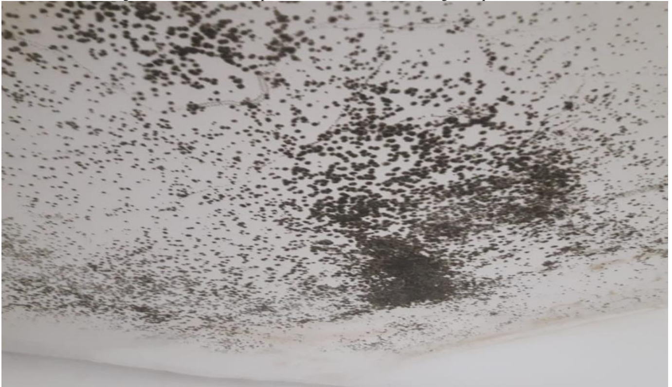
Figura 14: Vista interna do apartamento 3º andar. Bolores e fungos no quarto de casal
