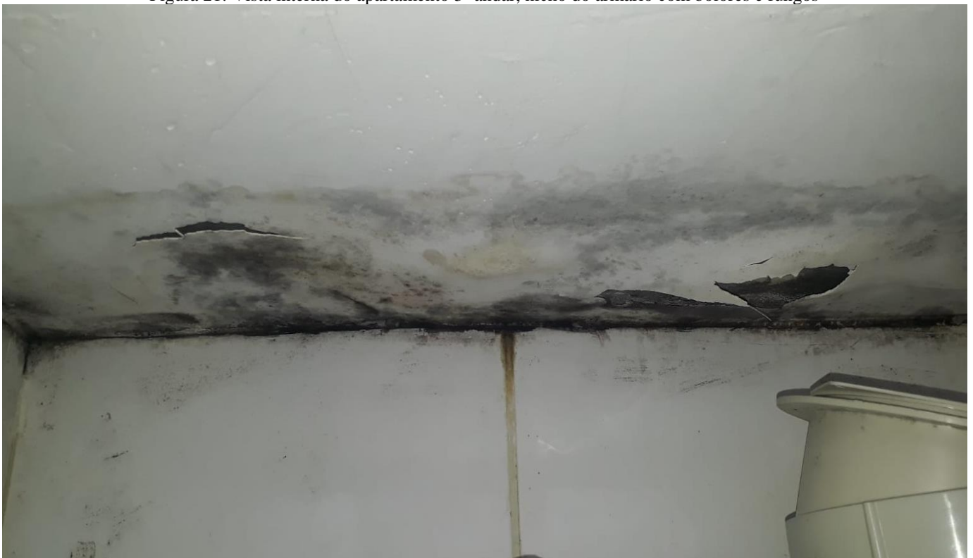
Figura 21: Vista interna do apartamento 3º andar, nicho do armário com bolores e fungos
