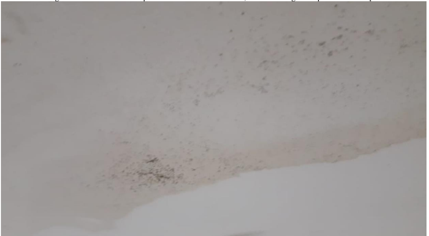
Figura 15: Vista interna do apartamento 3º andar. Umidade, bolores e fungos no quarto das crianças
