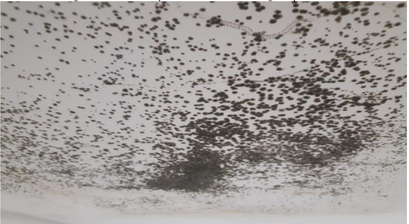
Figura 13: Vista interna do apartamento 3º andar. Bolores e fungos no quarto de casal
