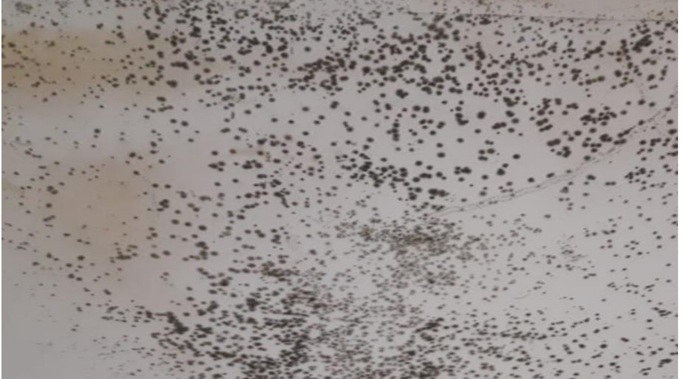
Figura 16: Vista interna do apartamento 3º andar. Umidade, bolores e fungos no quarto das crianças
