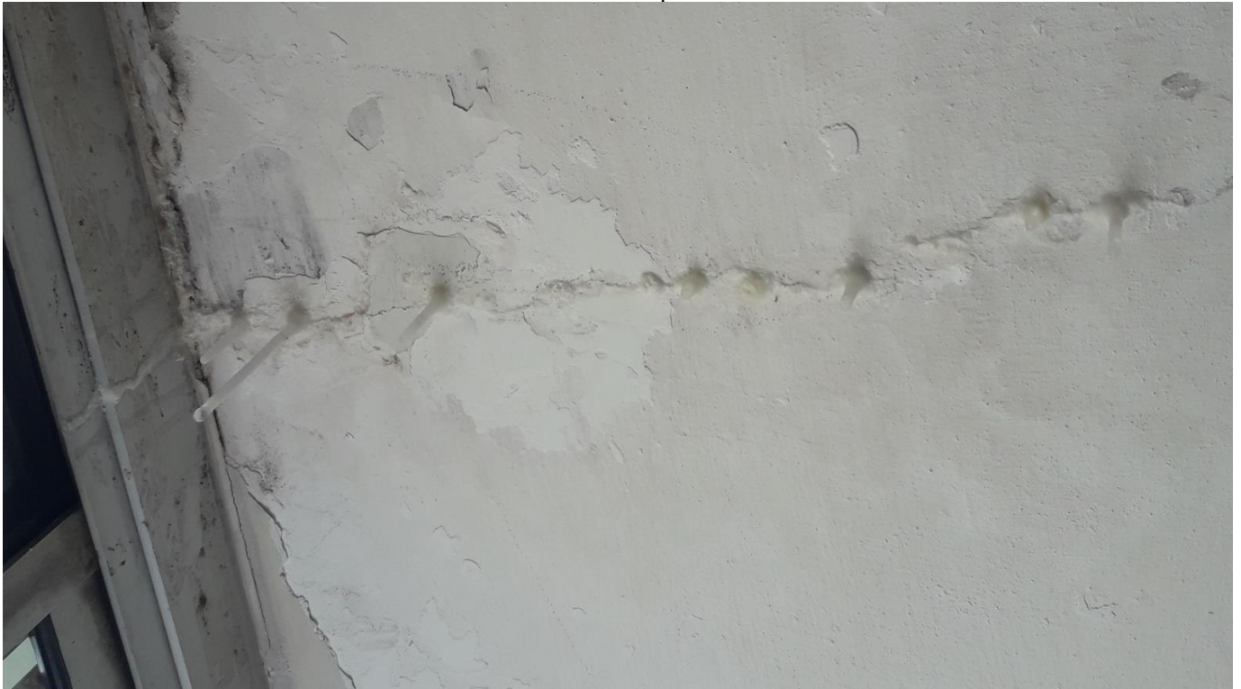
Figura 12: Vista interna do apartamento 3º andar. Infiltração na laje da sala e formação de estalactites, deslocamento da massa niveladora e da pintura
