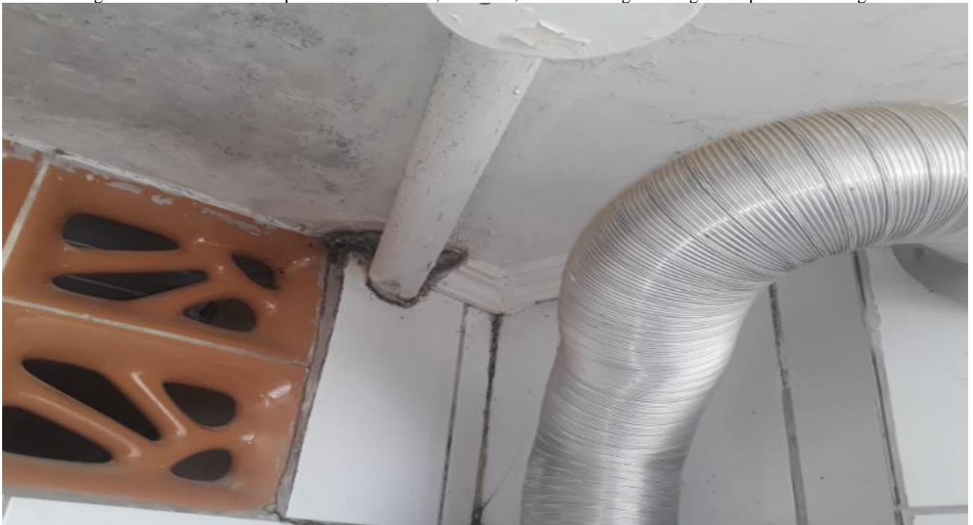
Figura 7: Vista interna do apartamento 1º andar, umidade, bolores e fungos na região da prumada de esgoto
