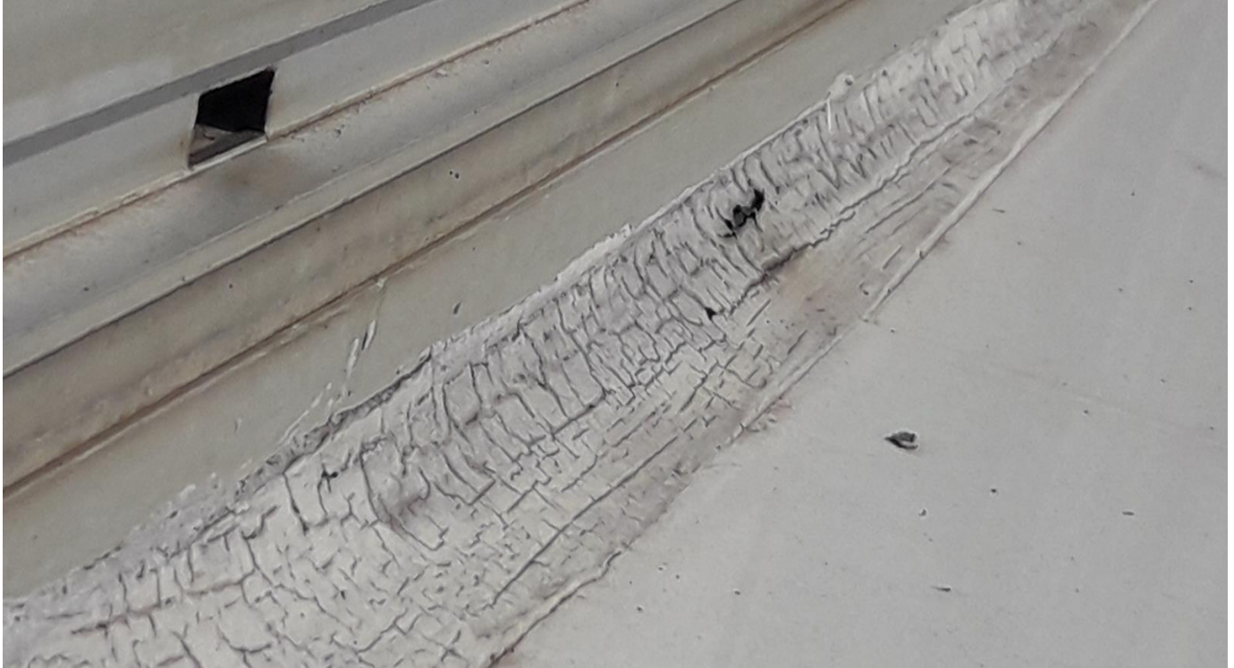
Figura 18: Vista da janela do apartamento 3º andar, fissuras na massa de calefação
