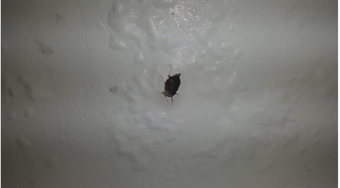
Figura 24: Vista interna do apartamento 3º andar, teto do banheiro com bolores, fungos e estufamento da pintura
