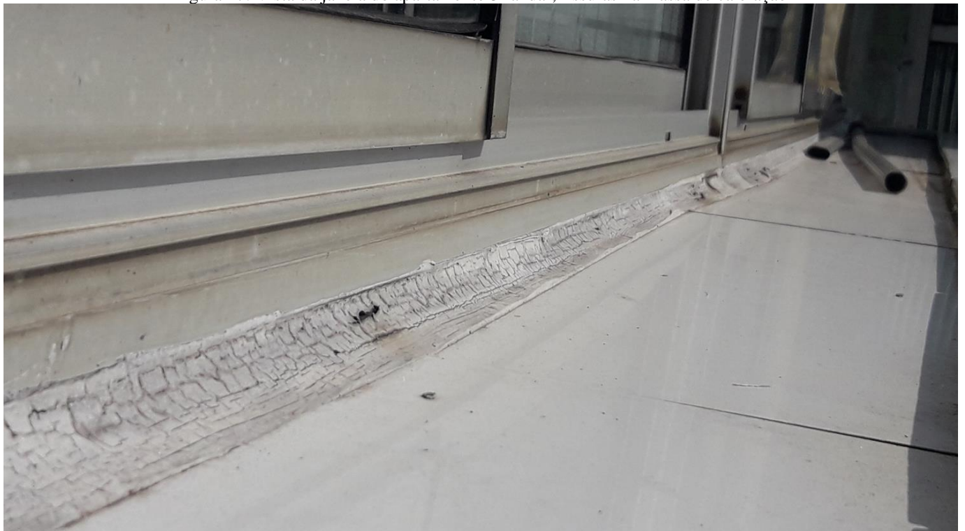
Figura 17: Vista da janela do apartamento 3º andar, fissuras na massa de calefação
